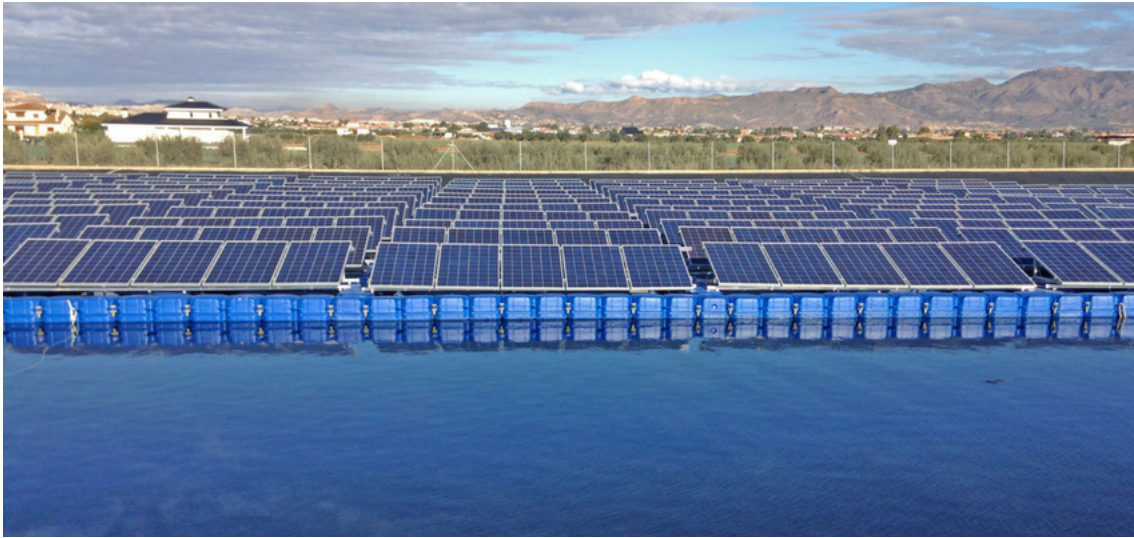
Figura 3.20. Instalación solar flotante en Murcia (España)
