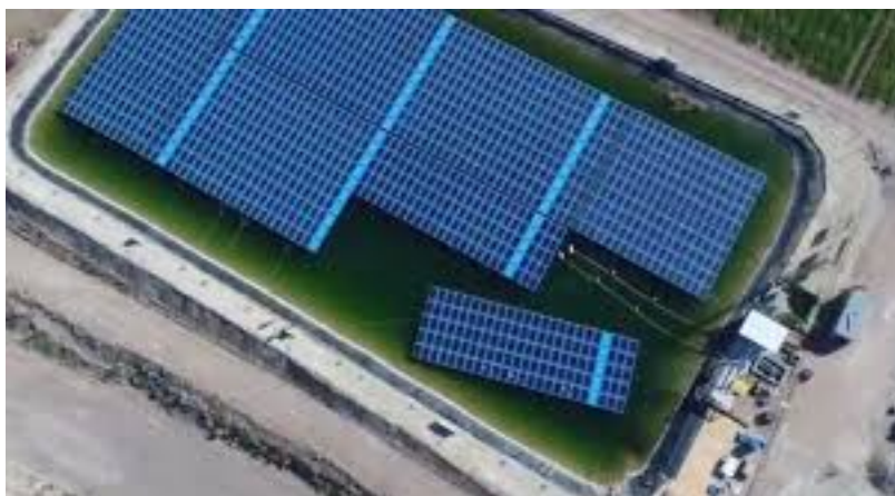
Figura 3.19. Instalación solar flotante
