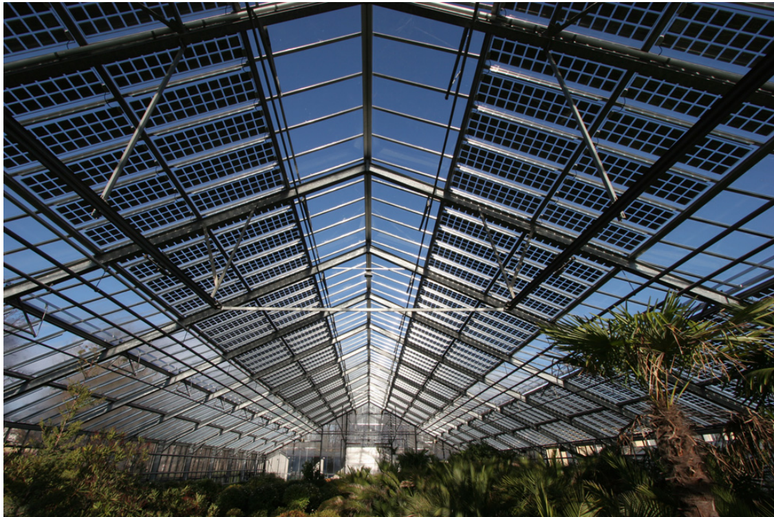
Figura 3.14. Invernadero fotovoltaico de estructura fija
