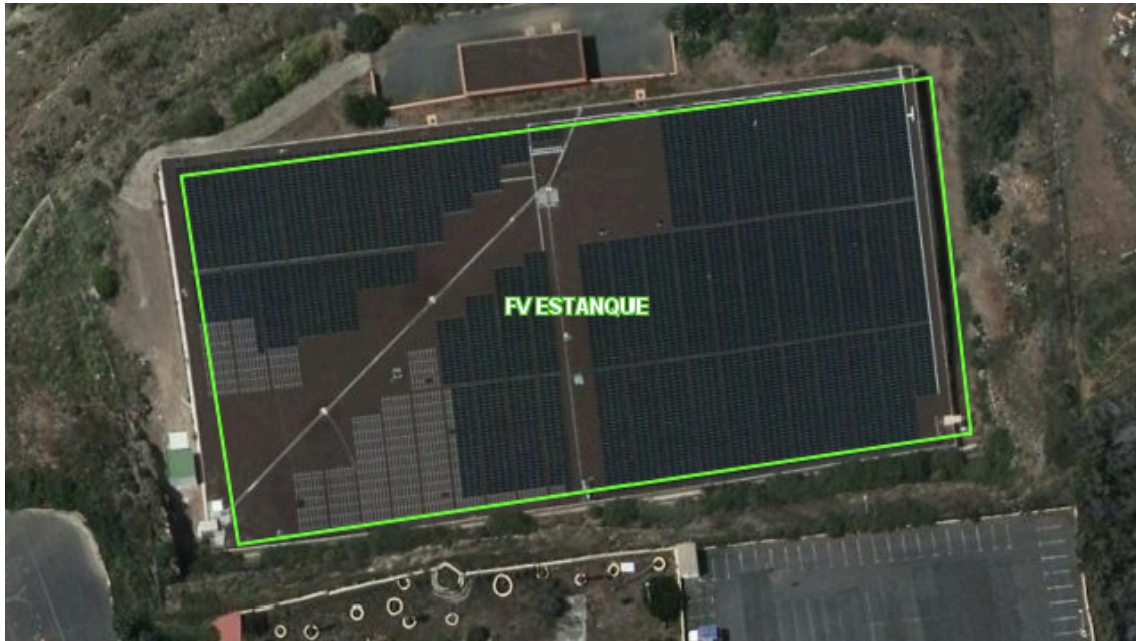
Figura 3.11. Depósito descubierto con instalación fotovoltaica en Arinaga
